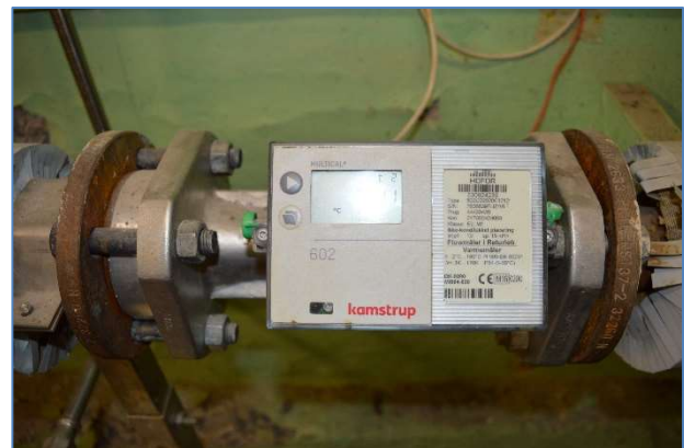
Foto 6: Fjernvarme temperatur retur 41C
