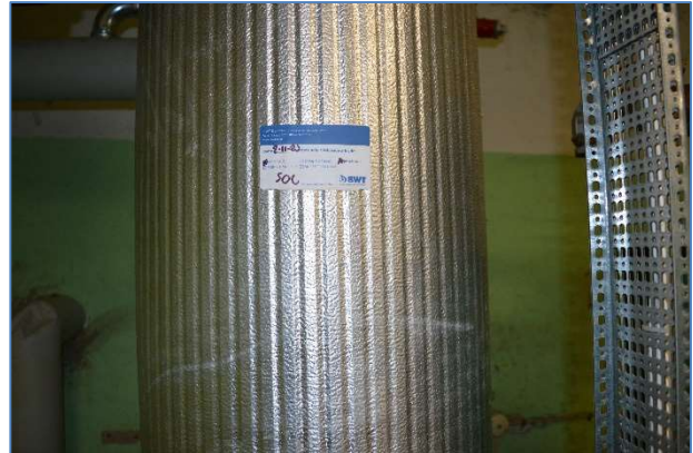
Foto 2: Varmecentral – varme/Brugsvands vekslere
