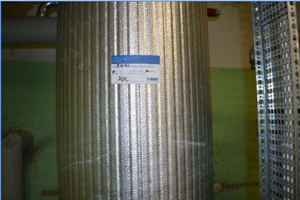
Foto 1: Varmecentral – varme/Brugsvands vekslere
