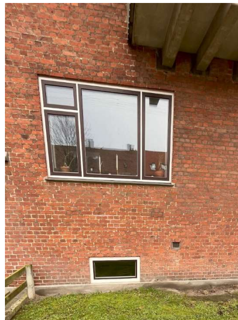
Foto 2: Vindue til lejlighed.
