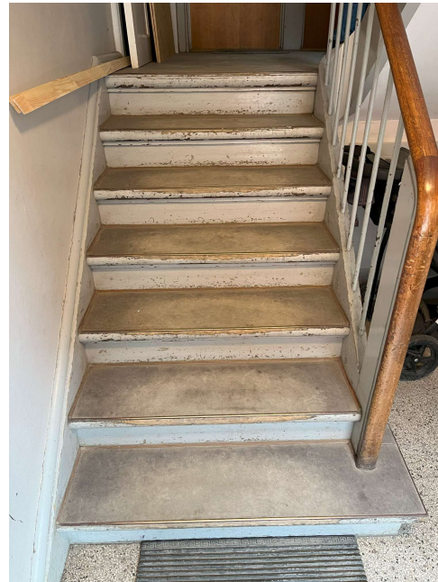
Foto 2: Trappeløb på fra terrazzoplatform i stueplan.
