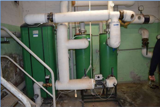
Foto 1: Varmecentral – varme/Brugsvands vekslere
