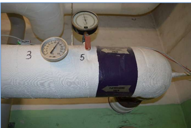
Foto 5: Fjernvarme fremløb 71C
