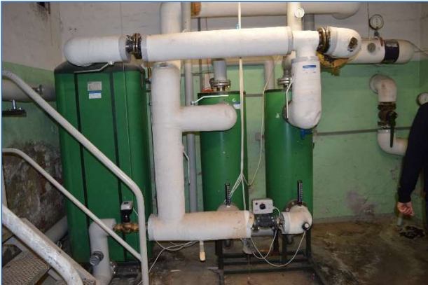
Foto 1: Varmecentral – varme/Brugsvands vekslerer
