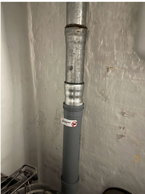
Foto 3: Faldstamme i kælder
