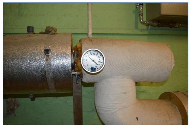
Foto 6: Fjernvarme retur 35C
