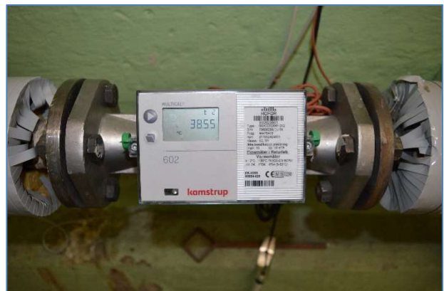
Foto 6: Fjernvarme temperatur retur 39C
